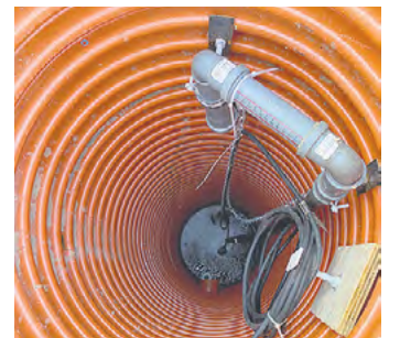
Blick in das Pumpwerk. Foto: ZV
