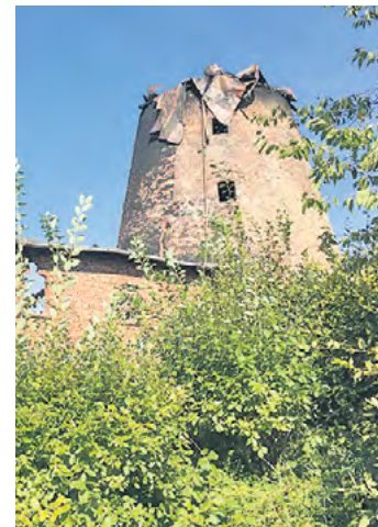
Die historische Wendorfsche Mühle ist nach dem verheerenden Feuer Anfang August nur noch eine Ruine. Foto: SPREE-PR/Hultzsich
