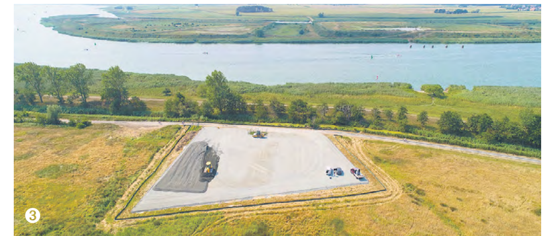
1 – Ein seltener Anblick: So sehen die Behälter aus, die das Abwasser im Hauptpumpwerk Karlshagen sammeln, bis es weiter nach Wolgast geleitet wird. Im Pumpwerk sind sie unterirdisch verbaut. 2 – Überraschender Fund: In Peenemünde brachten die Arbeiten einen alten Abwassersammelraum zu Tage. 3 – Die neue Druckleitung führt auch unter der Peene entlang. Ein sogenannter Düker wurde dafür zwischen Karlshagen und Hollendorf verlegt und verbindet die Insel mit dem Festland. Foto: ZV Usedomer
