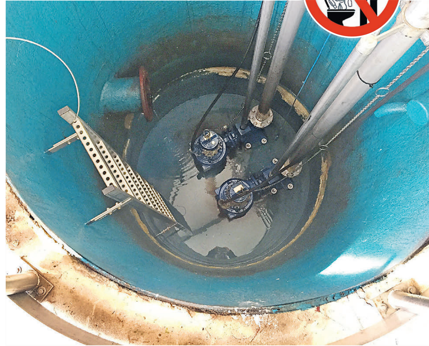
So sieht ein Abwasser-Pumpwerk von innen aus. Der ZV wartet die Anlagen im regelmäßigen Turnus, so dass die Weiterleitung zur Kläranlage stets gewährleistet ist. Was Kunden tun können: Die Toilette bitte nicht als Mülleimer benutzen! Foto: SPREE-PR/Archiv
