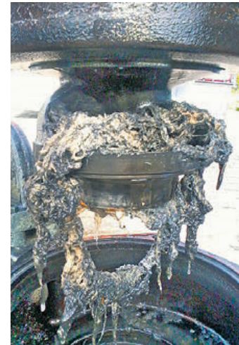
Wickeln sich feuchte Tücher im Inneren um die beweglichen Teile, setzt eine solche „Verzopfung“ die Abwasserpumpe irgendwann außer Gefecht. Foto: ZV
